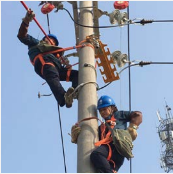
Les ingénieurs sont essentiels pour la conception, la construction et l'entretien d'infrastructures d'énergie. © Chinese Society for Electrical Engineering
