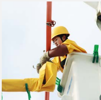
Femmes ingénieurs travaillant sur des systèmes électriques haute tension. © Chinese Society for Electrical Engineering
